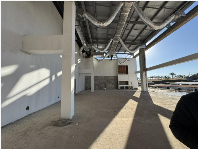
Infraestrutura para Ar Condicionado – 1º Pav.
