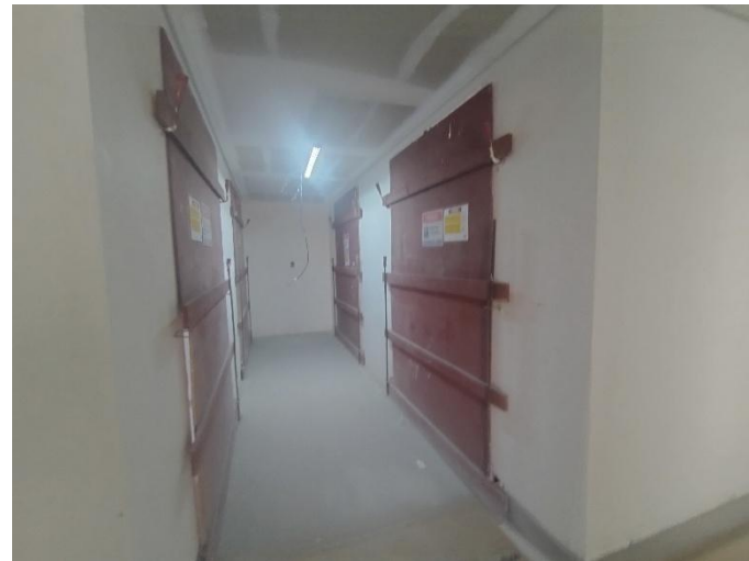
Proteção de Vãos de Elevadores
