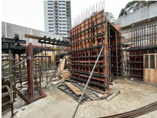
Laje piso do 1.º subsolo e estrutura para parte da laje do Térreo
