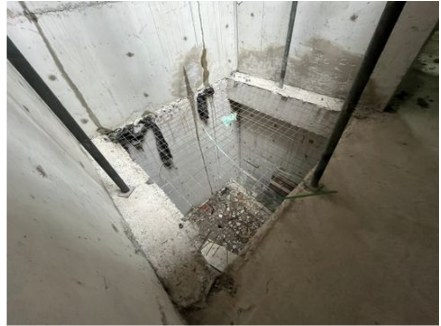
Vão de poço de elevador protegido
