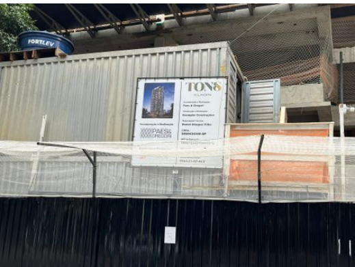
Placa da Construtora
