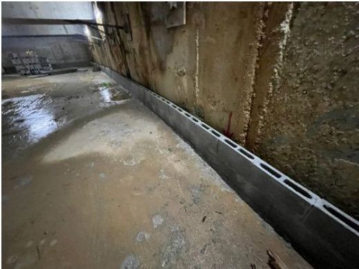
Canaleta para parede de PVC no 1.º subsolo
