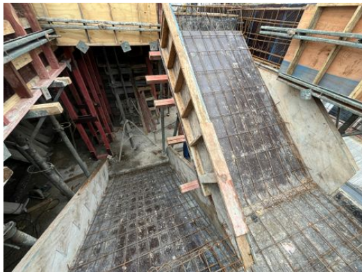
Formas com início da armação em escada de acesso do 4.º para o 5.º andar
