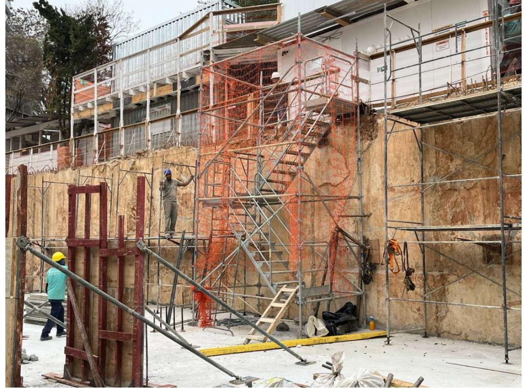
Escada metálica para acesso à obra protegida, porém com pequena escada de madeira na última parte
