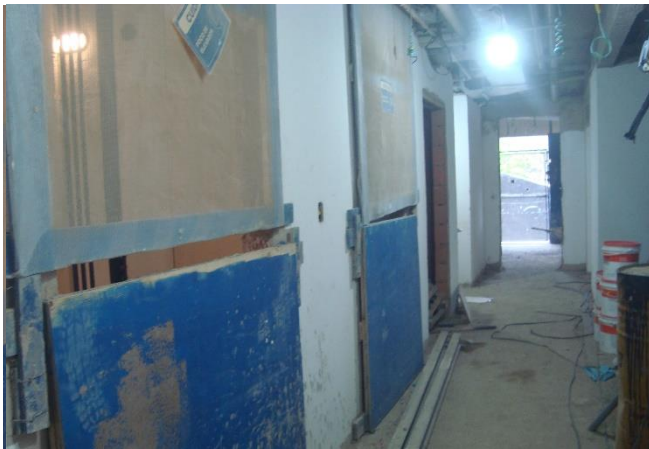
Proteção de Vãos de Elevador
