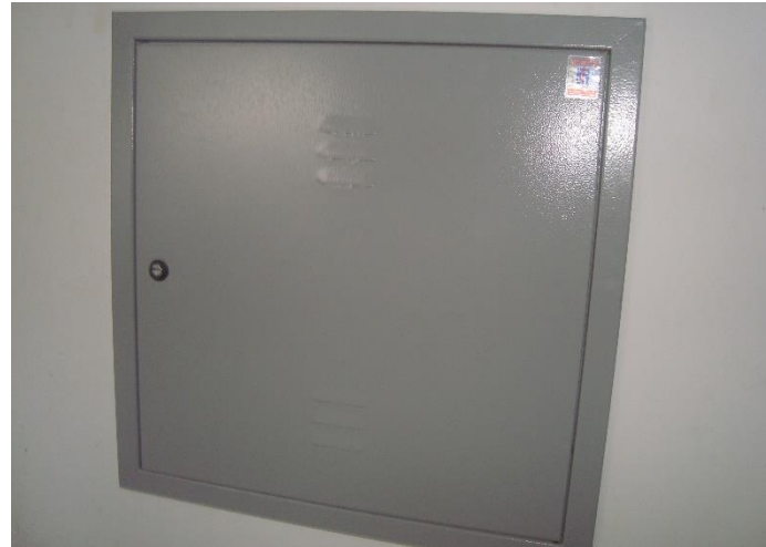
Quadro Elétrico – 3º Pav
