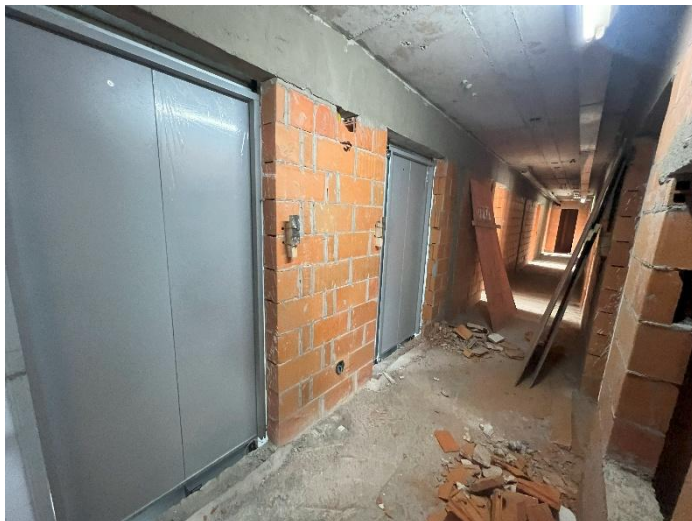
Porta de Elevador – 15º Pav
