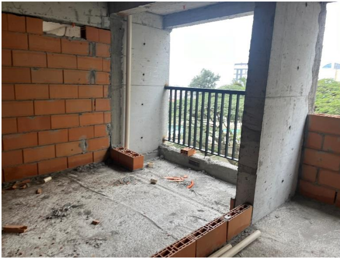
Guarda Corpo – 3º Pav
