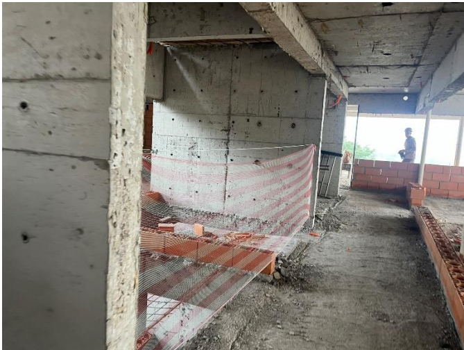
Proteção de Vão de Elevador
