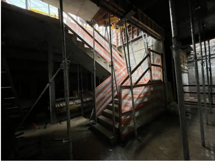
Vãos de escada protegidos
