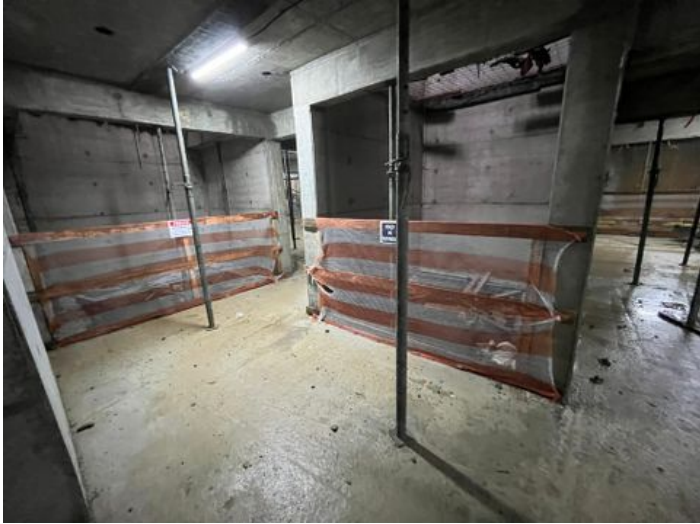
Proteção em vão de elevadores
