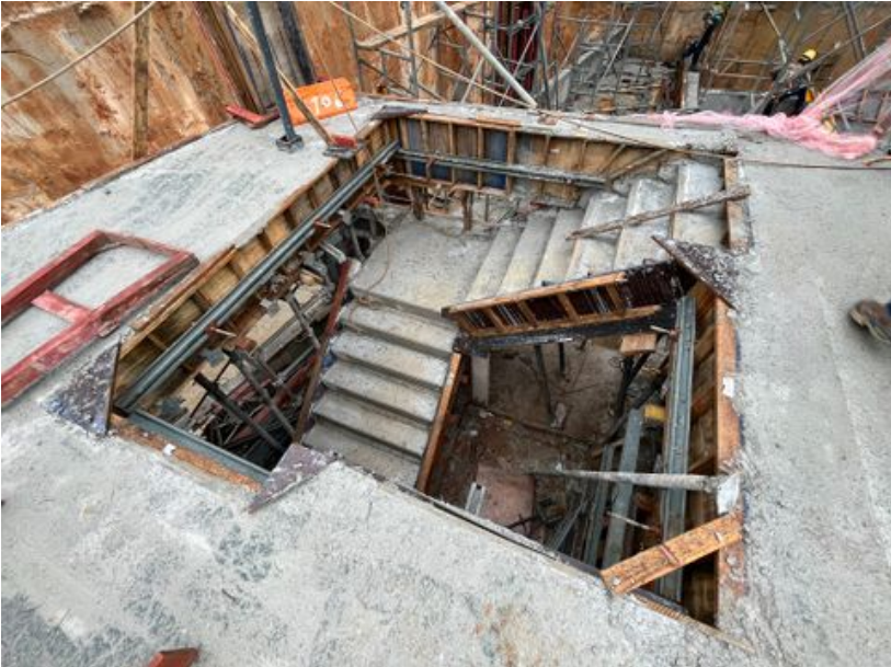
Trecho escada do mezanino sem a devida proteção contra quedas
