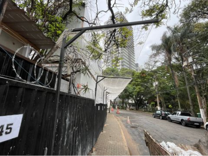
Tela de proteção na calçada
