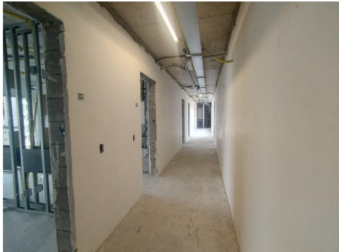
Eletrocalhas – 13º Pav
