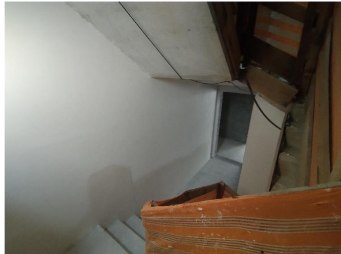
Proteção Perimetral Escadaria
