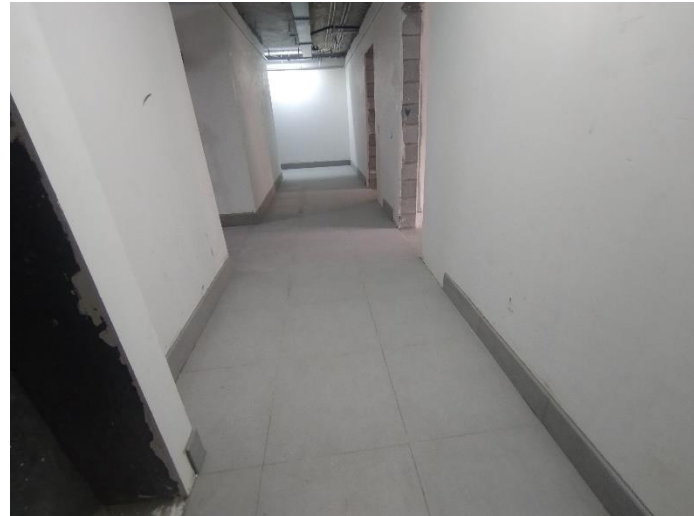
Piso em Porcelanato – 3º Pav
