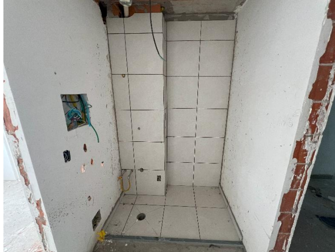
Cabos de Instalações – 8º Pav
