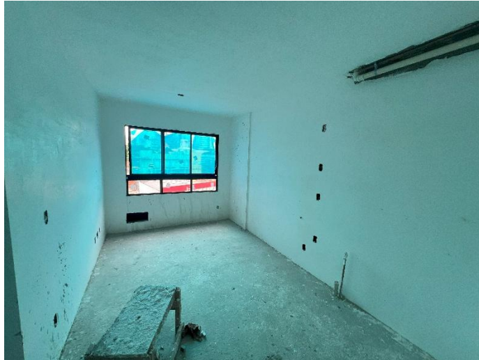
Janela de Alumínio – 5º Pav
