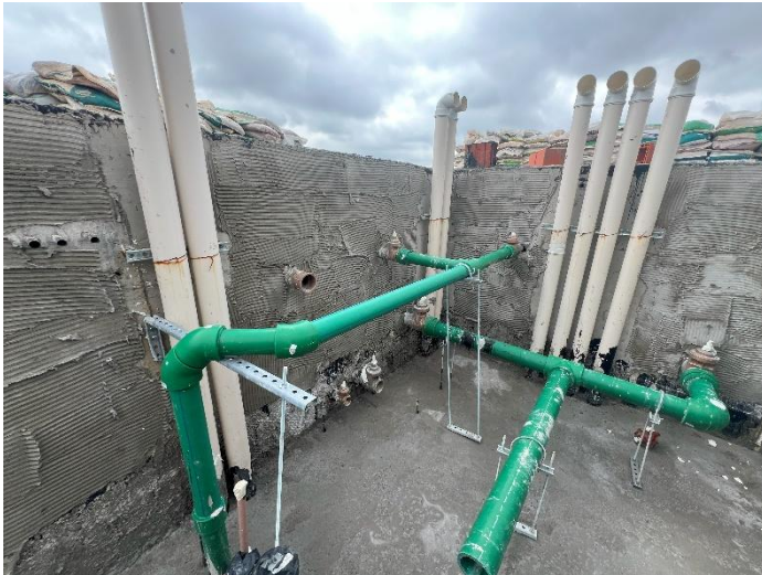
Distribuição Hidráulica – Cobertura
