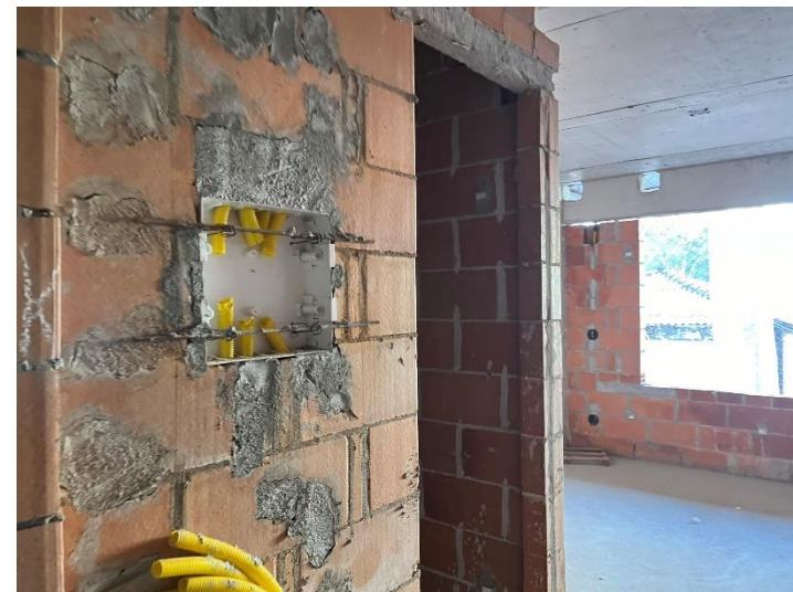
Fundo de Quadro – 1º Pav
