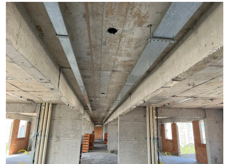
Eletrocalhas – 15º Pav
