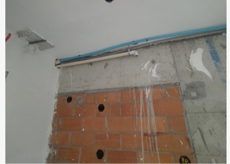
Embutidos em Alvenaria – 11º Pav.
