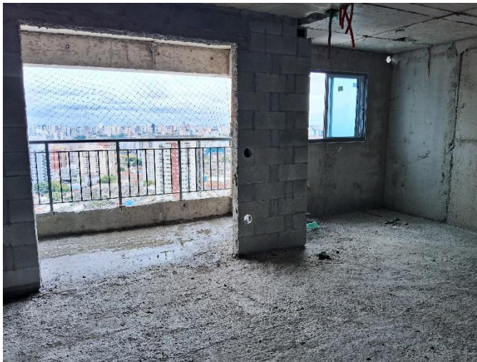
Rede Piso a Piso
