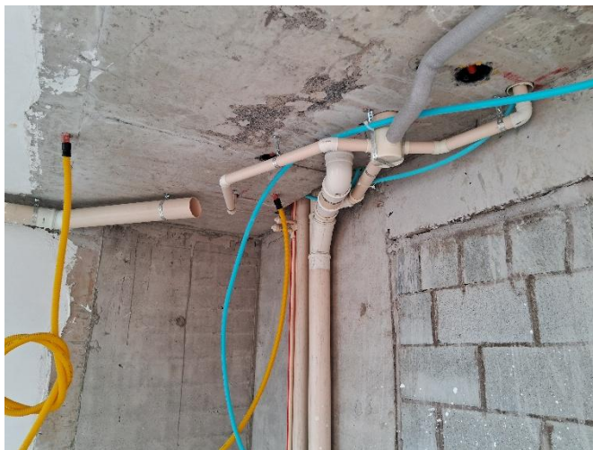
Prumada de Esgoto – 11° pav
