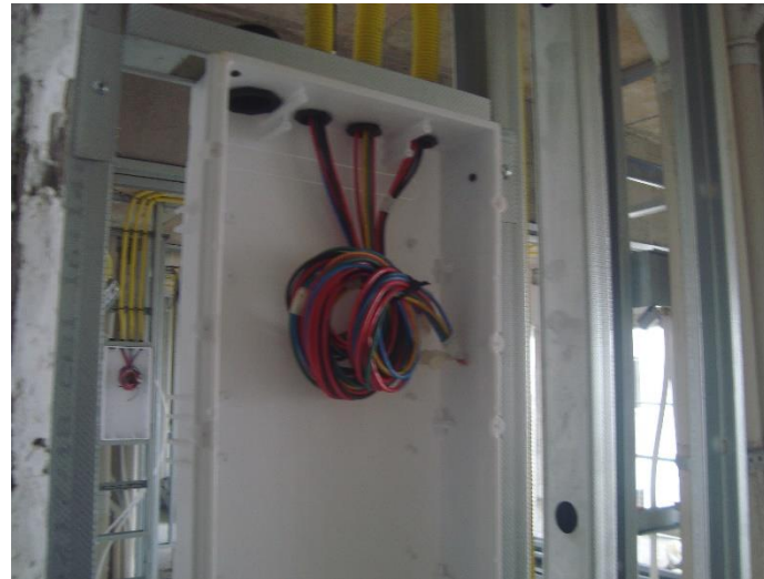
Cabos de Instalações – 20º Pav
