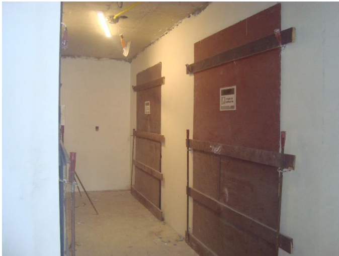
Proteção dos Vãos de Elevador
