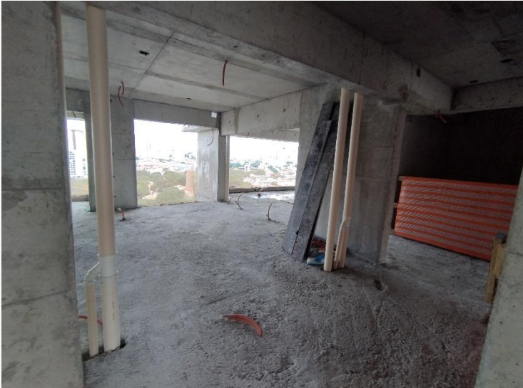
Prumada Hidráulica – 13º Pav.
