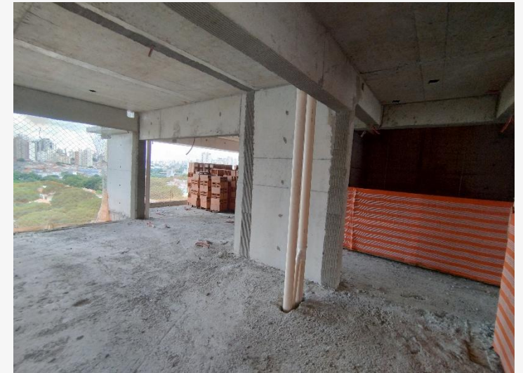
Prumada Hidráulica – 11º Pav.
