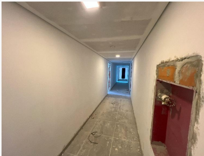
Caixa de Hidrante – 4º Pav.
