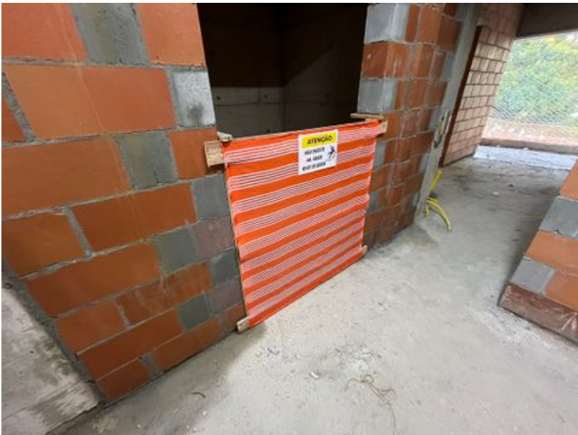
Vão elevador protegido
