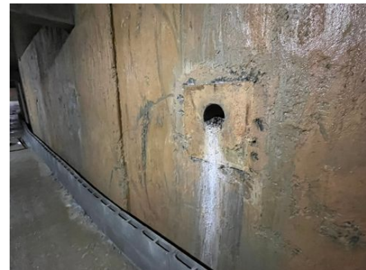
Tirante desprotendido com o tamponamento ainda a ser realizado, no 2.º subsolo
