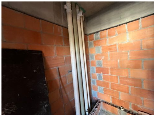
Prumadas hidráulicas no 1.º andar
