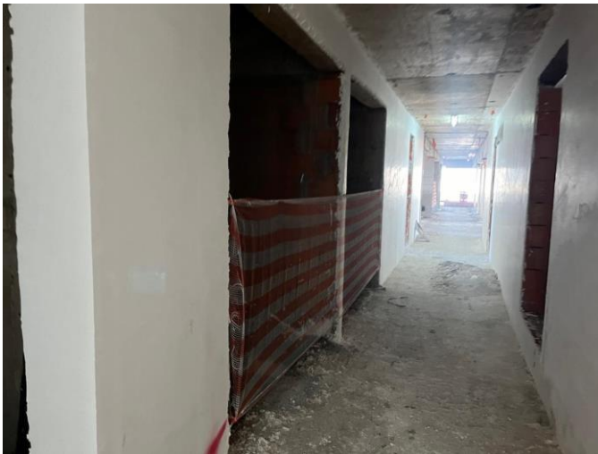
Proteção de Vão de Elevador
