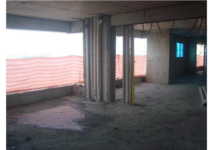
Prumadas Hidráulicas – 16° Pav
