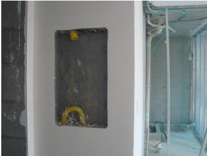
Fundo de Quadro – 8º pav
