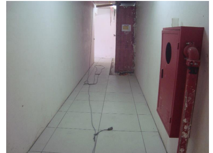
Caixa de Hidrante – 5º Pav
