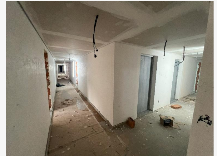
Cabos de Instalações – 6º Pav
