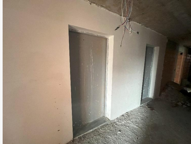
Cabos de Instalações – 16º Pav
