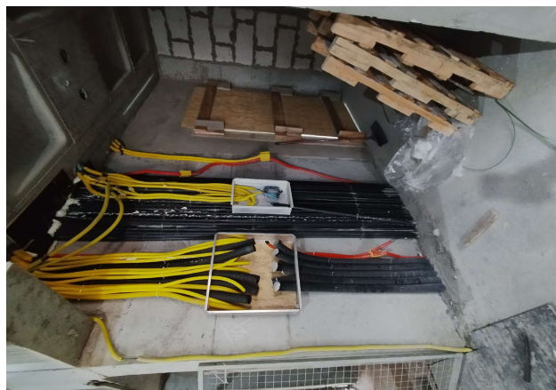
Foto 28 - Pav Mezanino Térreo Infra de elétrica
