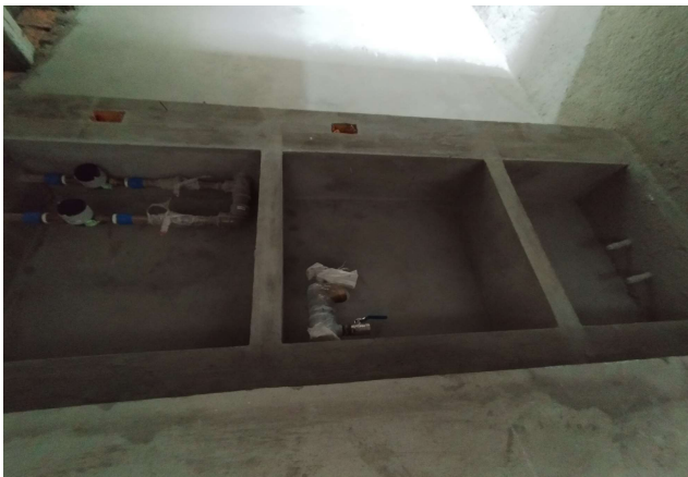
Foto 15 - Medidores de água, hidrante e espera do gás
