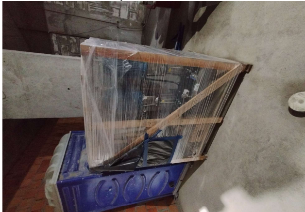
Foto 24 - Bombas de Recalque
