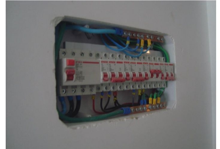
Disjuntores – 17º Pav
