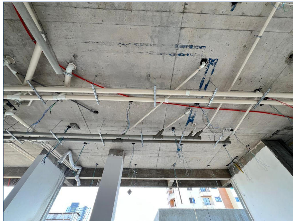
Foto 18 – Hidráulica área comum
