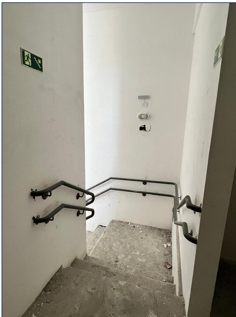
Foto 21 - Corrimão escadaria NR
