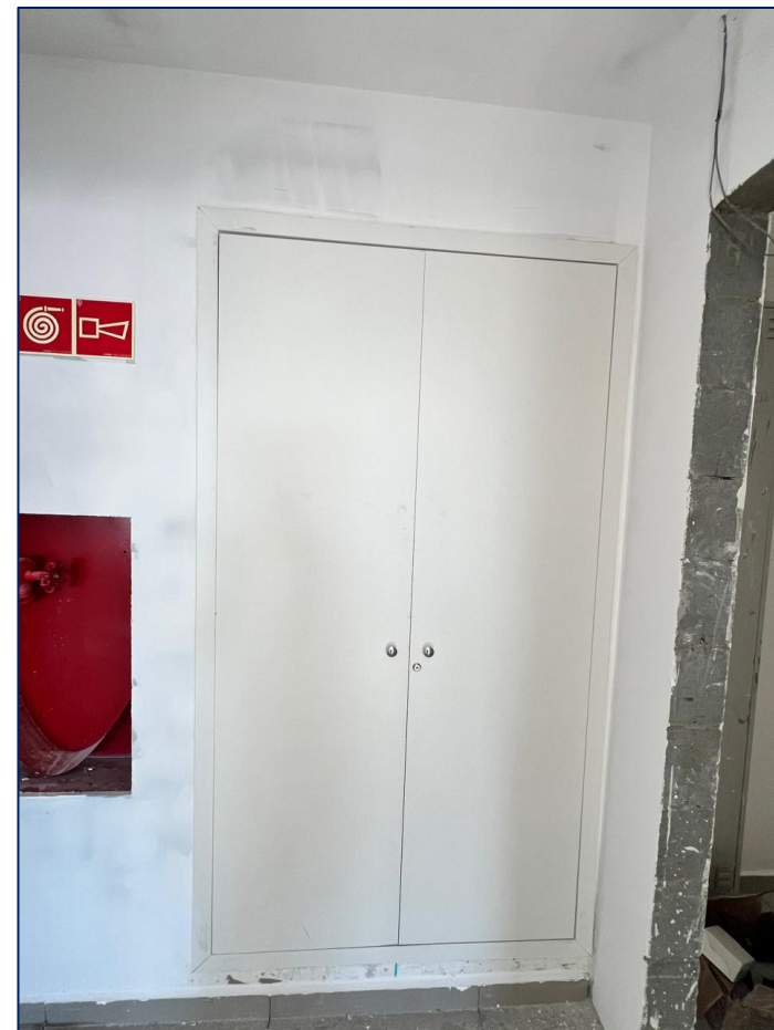
Foto 4 – Hidrante e portas de shaft - 21º pavimento
