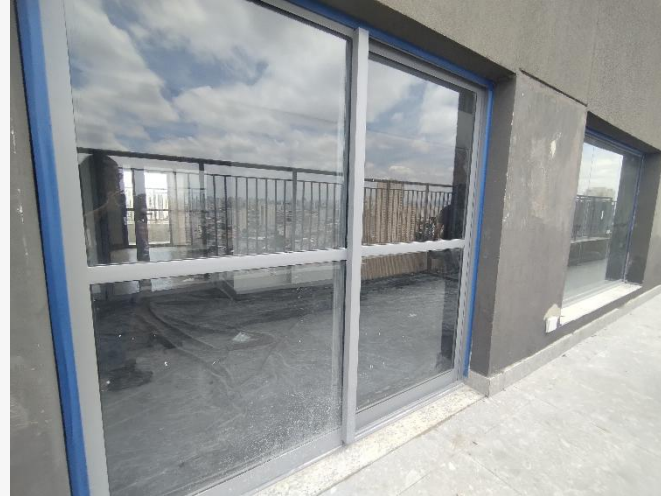
Portas de Alumínio com Vidro – 26° Pav.
