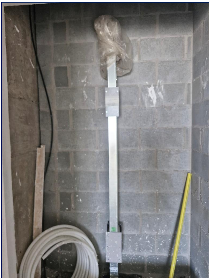
Foto 7 - Instalação busway - 15º pav
