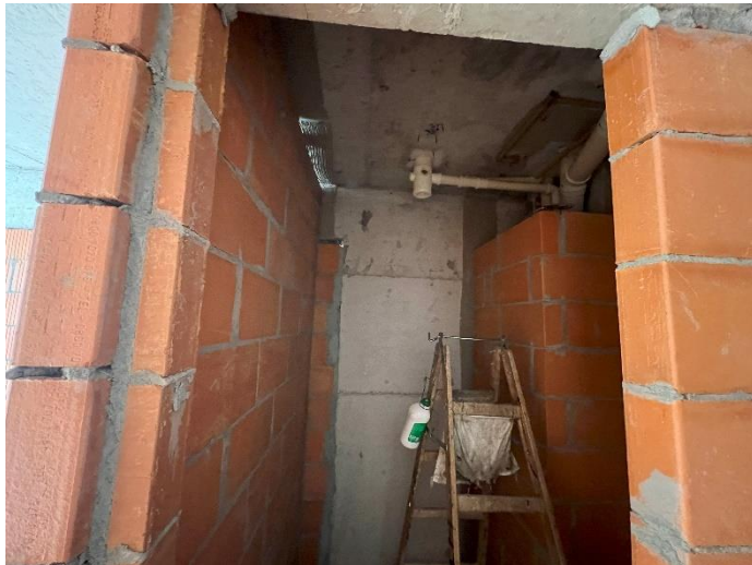
Ramais de Esgoto – 13º Pav
