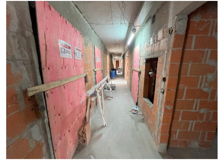
Caixa de Hidrante – 6º Pav
