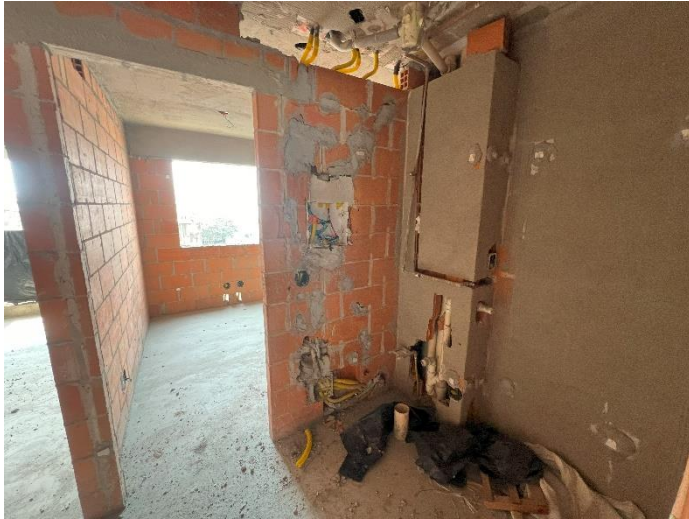
Ramais de Esgoto – 8º Pav
