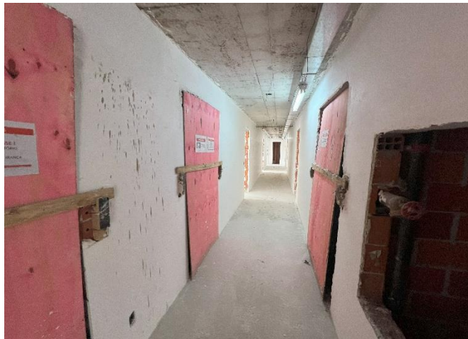
Proteções Vãos dos Elevadores
