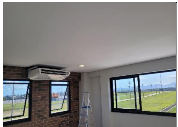
06 Ar Condicionado - Fitness/Spa.
