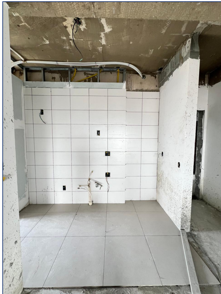
Foto 5 – Pisos e azulejos 21º pavimento
