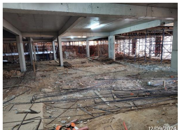
18 3ºSubsolo - Ainda sem drenagem e piso sobre terra.
