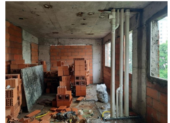
Prumada Hidráulica – 5º Pav
