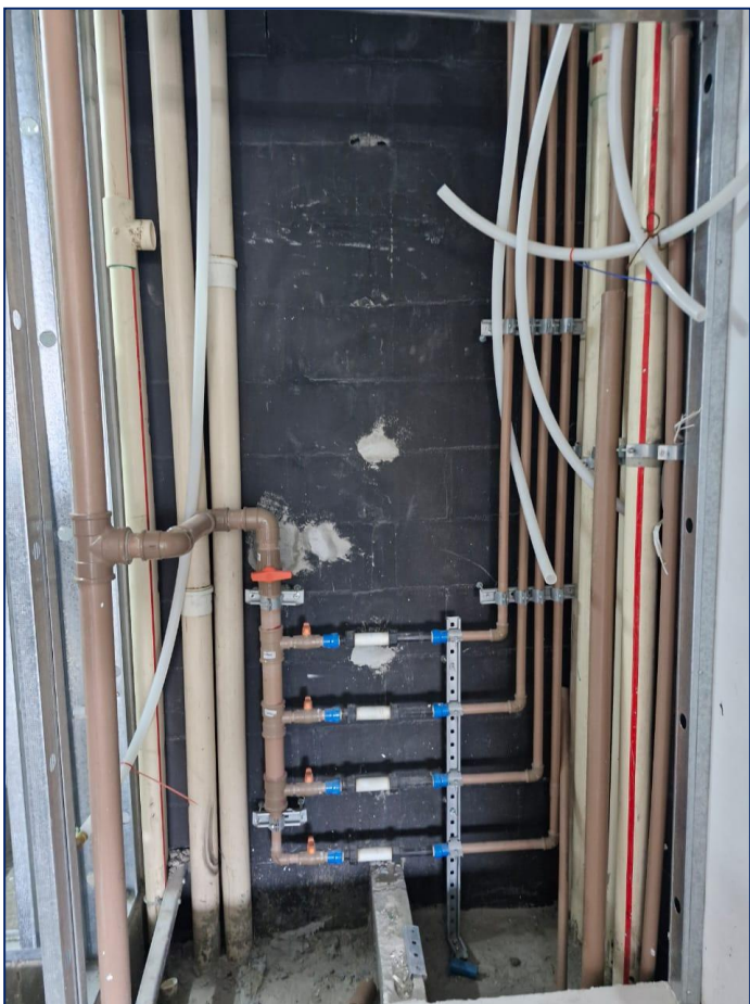
Foto 03 – Shaft instalações Hidráulicas
