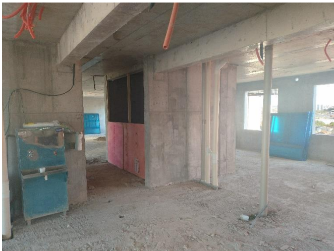
Proteção Vão de Elevador
