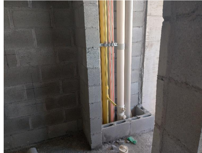
Prumadas Hidráulicas – 5° pav
