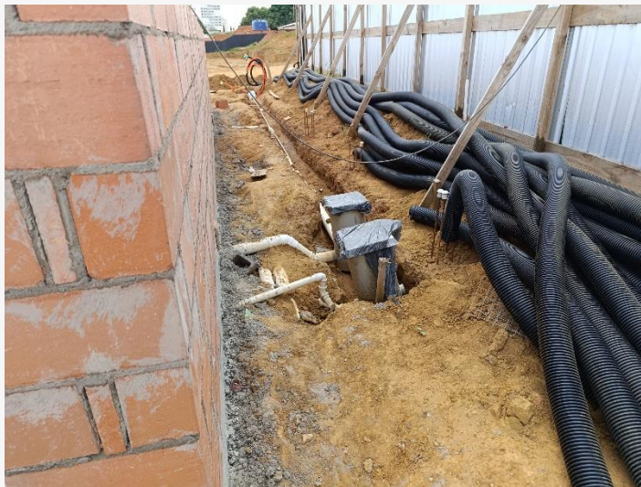
Infra Elétrica e Hidráulica
