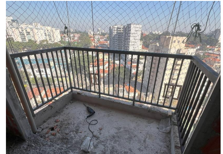
Guarda Corpo – 14º Pav
