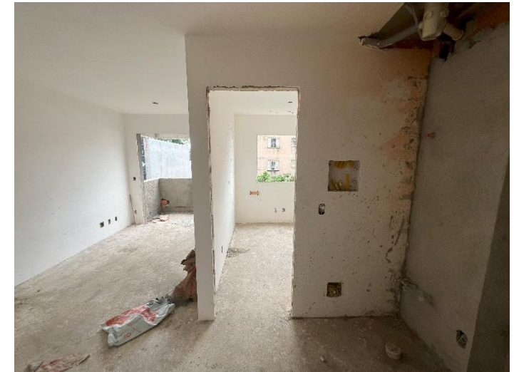
Fundo de Quadro – 5º Pav
