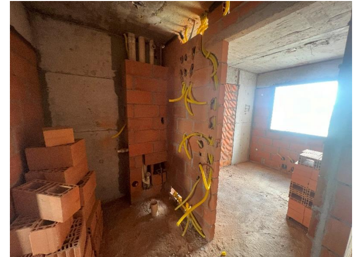
Embutidos em Alvenaria – 16º Pav
