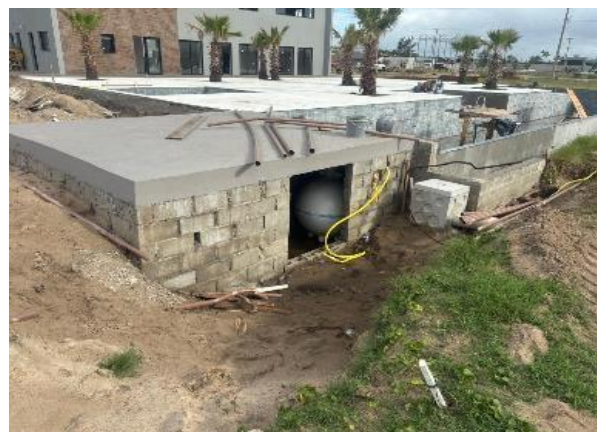
12 Bombas e Filtros das Piscinas.
