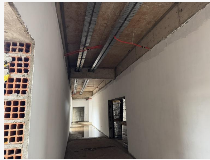
Eletrocalha – 1º Pav.
