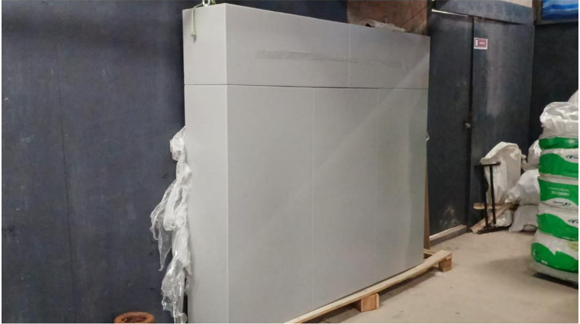
Foto 13 – QDC (quadro de distribuição de serviços);
