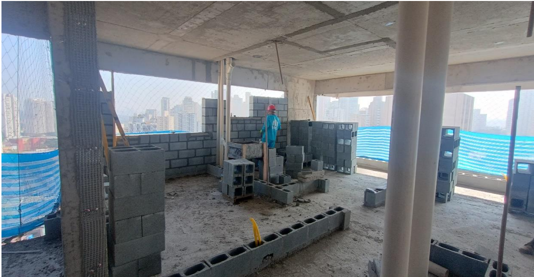
Foto 09 – 8º pavimento– Elevação de alvenaria, tubulação seca de elétrica e prumada hidráulica;
