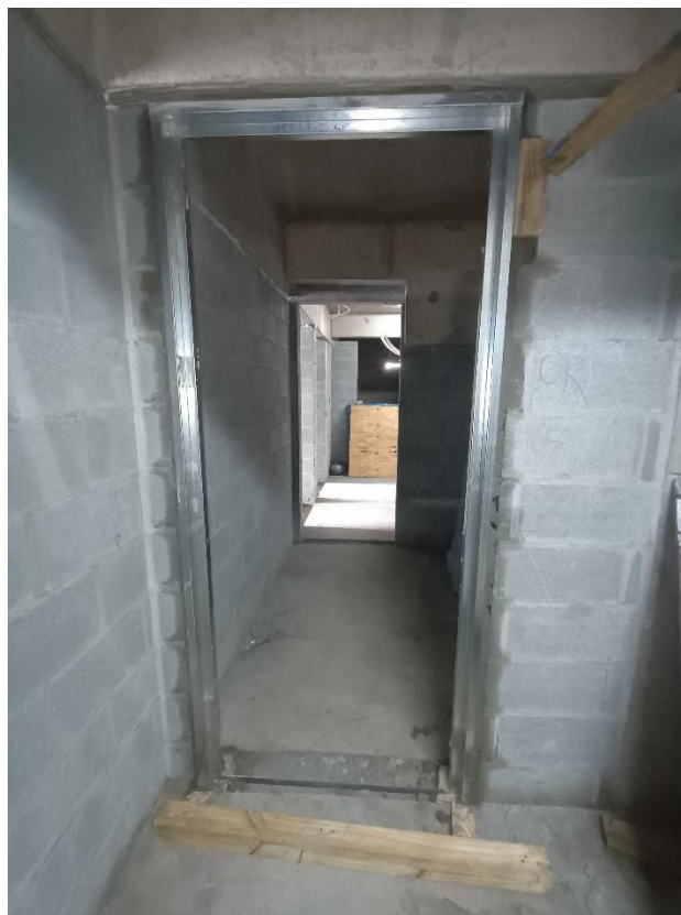
Foto 06 – 5º pavimento- marco ponta de emergência;
