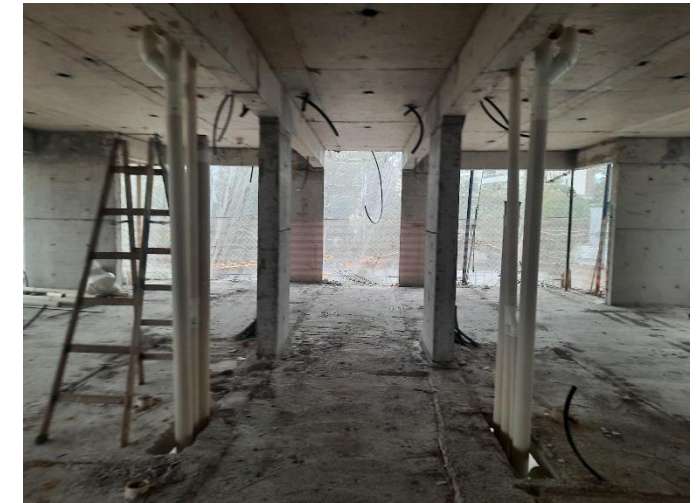
Prumada Hidráulica – 7º Pav TS
