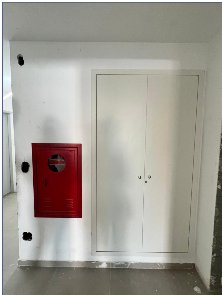
Foto 19 – Portas de Shaft e Hidrante - 4º pav
