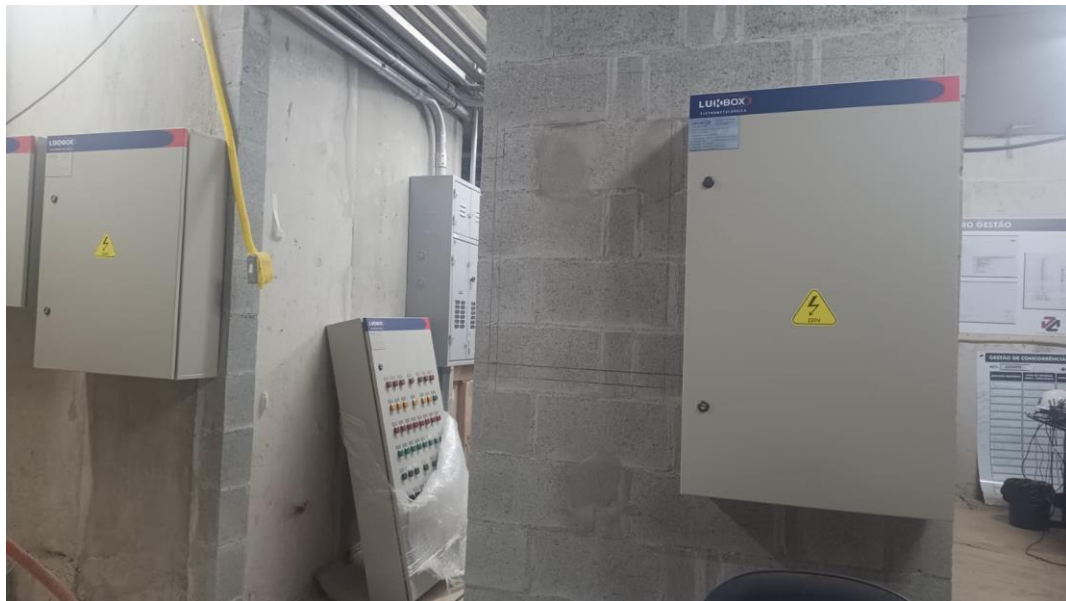
Foto 10 – Centro de Medição – quadro instalados;
