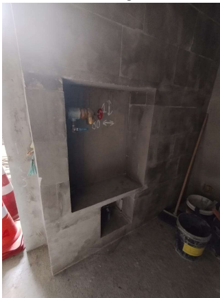
Foto 9 - Hidrante térrico e entrada do gás natural
