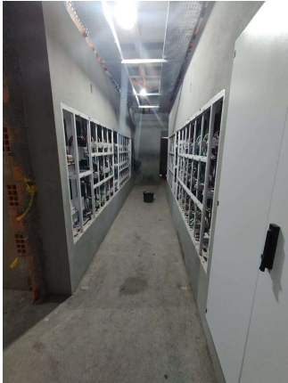
Foto 13 - Quadros de Energia T rreo
