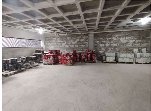
Foto 14 - Dep sito de materiais de pintura
