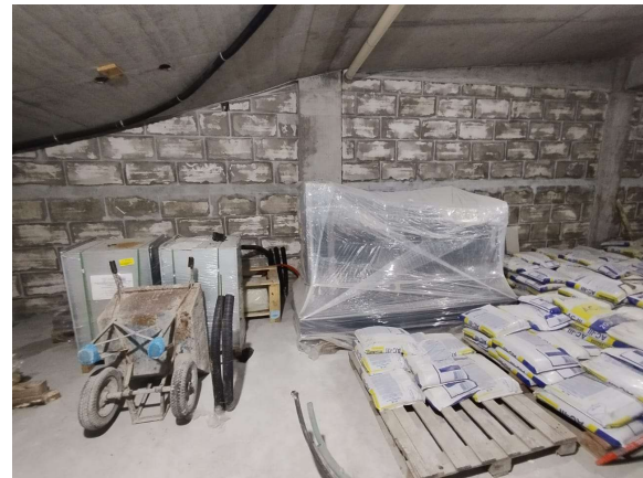
Foto 10 - Atenuadores de ruído
