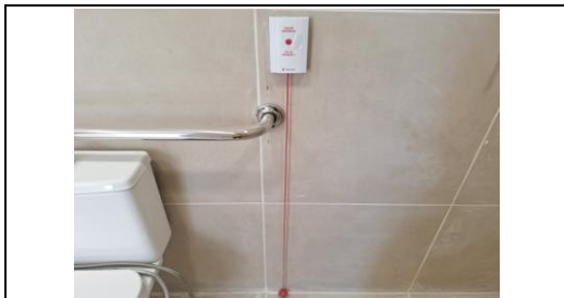
Botoeira de emergência do banheiro do leito
