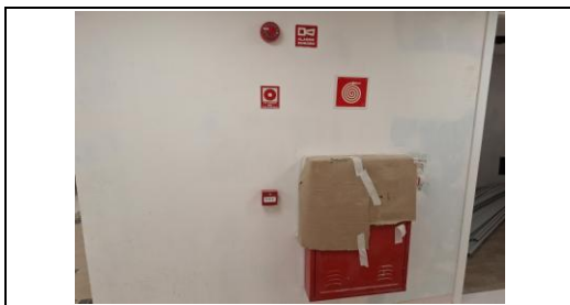
Caixa do hidrante e botoeira com alarme de incêndio
