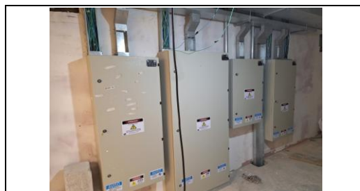
Quadros de energia elétrica
