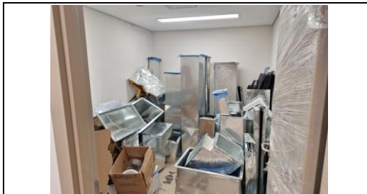
Estoque de dutos do ar condicionado
