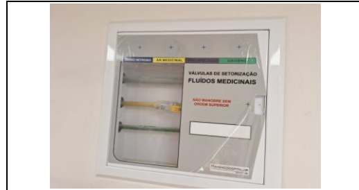
Válvulas de setorização dos fluidos medicinais
