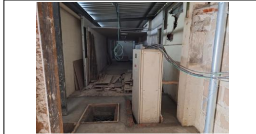
Corredor de acesso a área de máquinas
