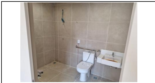
Banheiro do leito com instalações sanitárias e boteira
