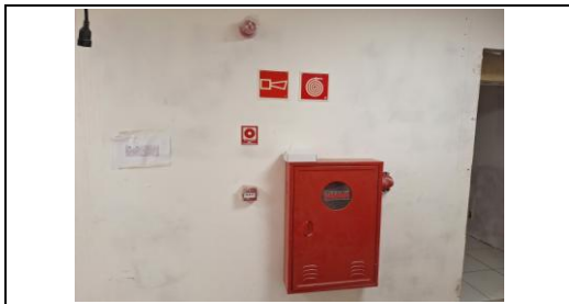
Caixa do hidrante, botoeira e alarme de incêndio
