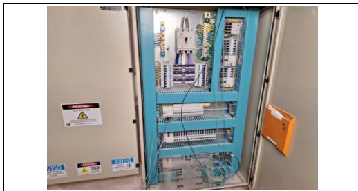
Quadro de energia elétrica
