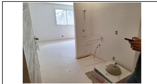
Leito sem a instalações do lavatório
