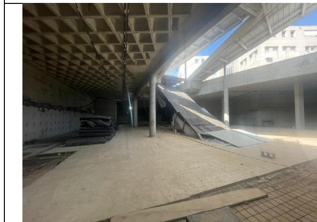
Vista do pavimento Inferior – escada rolante
