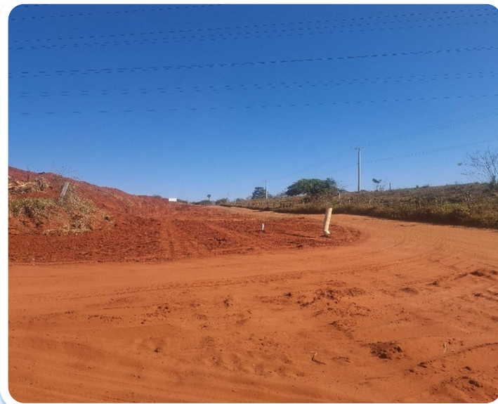
Foto 9 - Rede de águas pluvias nos acessos (área externa) do condomínio
