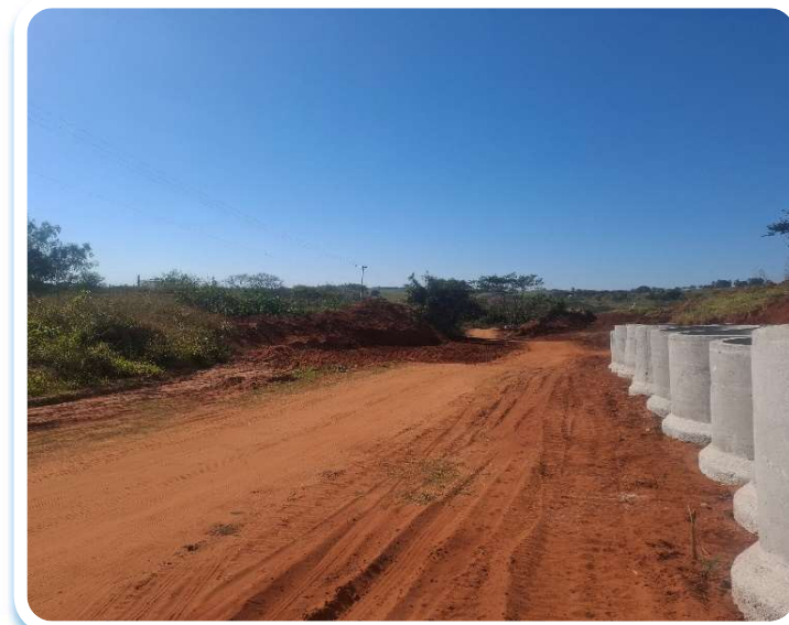
Foto 10 - Rede de águas pluvias nos acessos (área externa) do condomínio
