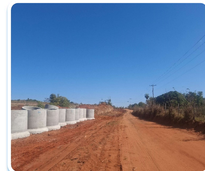
Foto 12 - Rede de águas pluvias nos acessos (área externa) do condomínio
