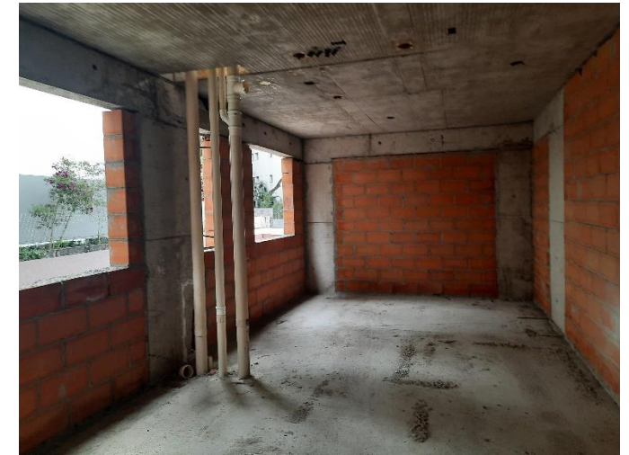
Prumada Hidráulica – 3º Pav
