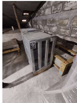
Foto 8 - Atenuadores de ruído
