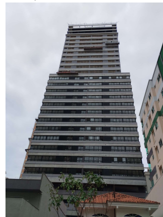
Foto 4 - Fachada sem esquadrias
