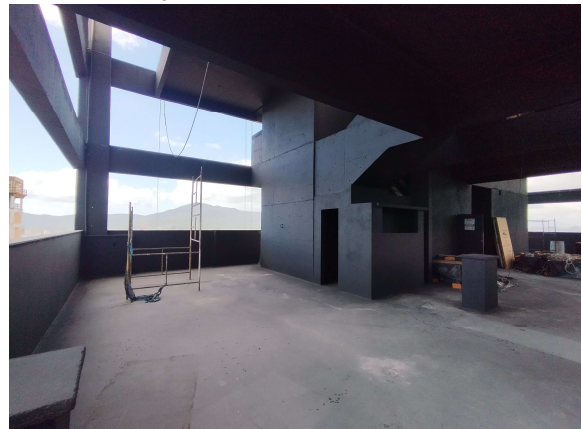
Foto 16 - Casa de Máquinas e Barrilete
