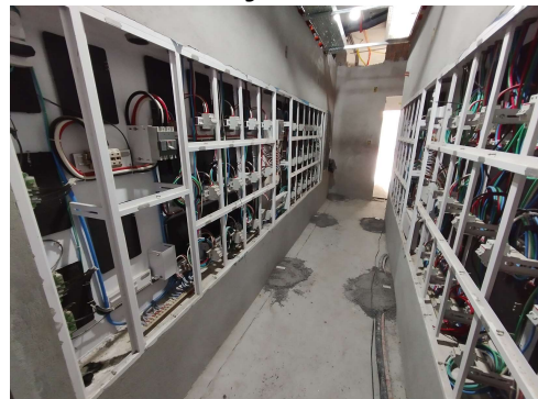
Foto 6 - Painel de entrada de energia
