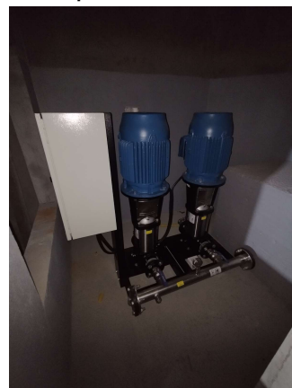
Foto 10 - Bombas de Recalque 15CV
