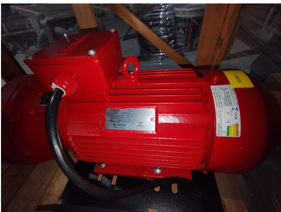
Foto 9 - Bombas de incêndio
