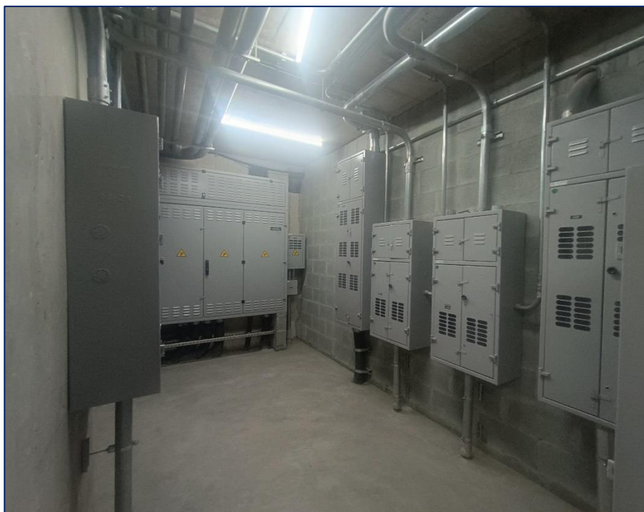
Foto 3 - Visão geral centro de medição
