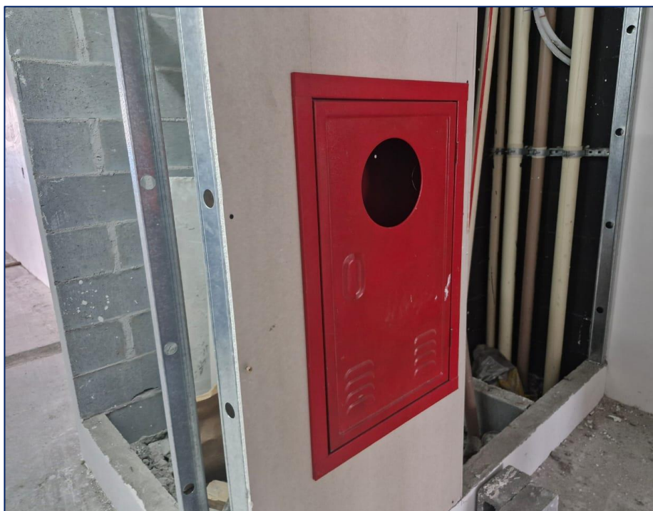
Foto 13 - Pontos de hidrante - 7º pavimento
