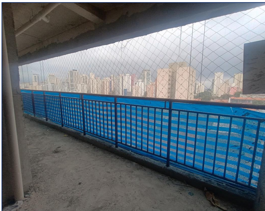
Foto 5 - Gradil varanda - 6º pavimento
