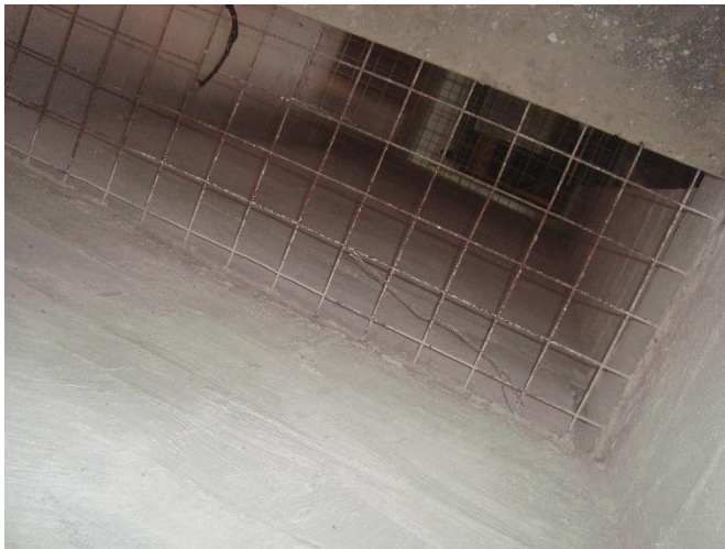
Proteção Vão de Elevador
