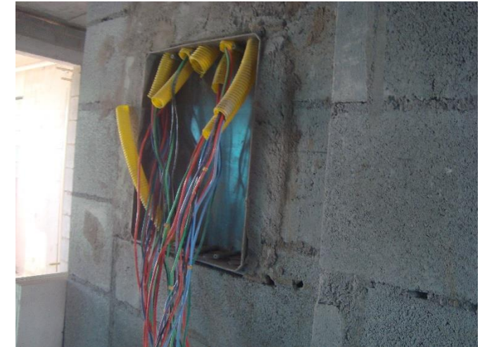
Cabos de Instalação – 4º Pav
