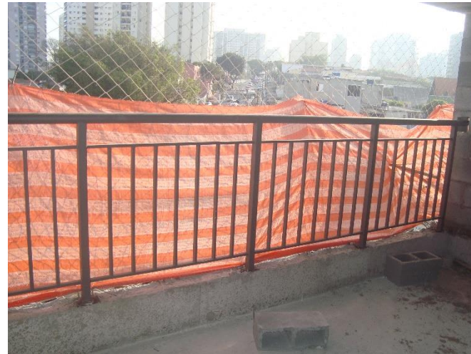
Guarda Corpo – 4º pav
