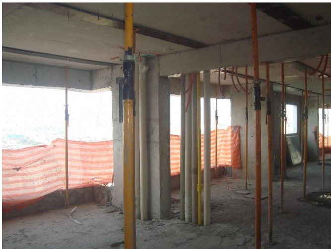
Prumadas Hidráulicas – 9° pav
