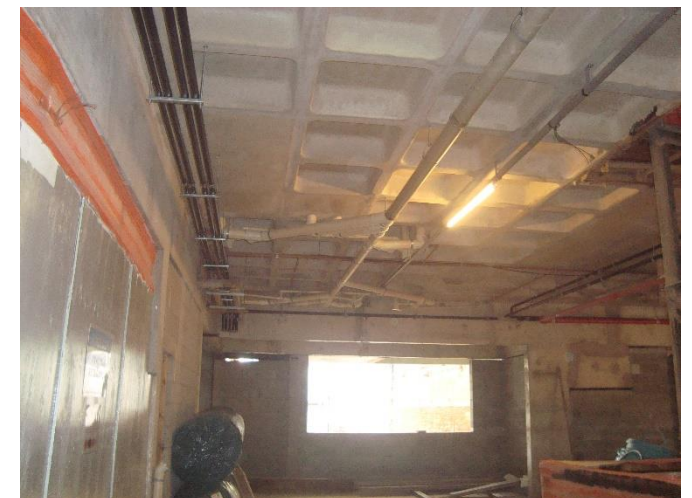
Tubulação Aparente – 1º SS
